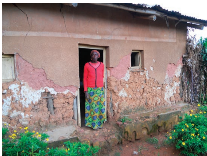
Mme Anastasie a 55ans ; elle vit avec sa fille et ses deux petits-enfants ; sa maison date des années 1960 ; les poteaux intérieurs des cloisons sont rongés par l'eau, les intervalles ont été bouchés par un mélange de boue et de paille ; les murs sont fissurés et le crépi extérieur tombe par larges plaques.
